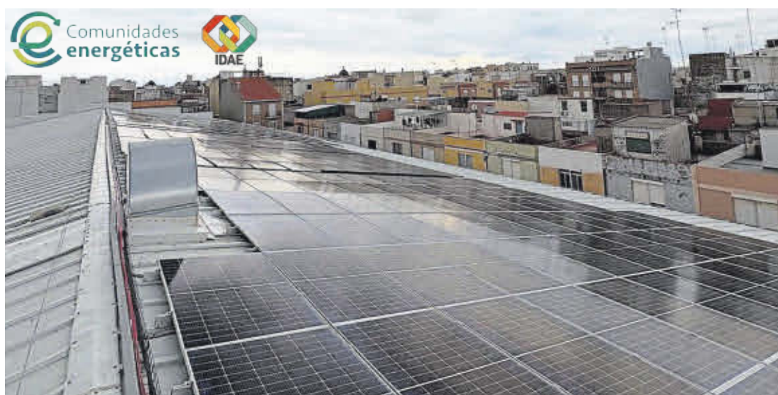
Les plaques solars de la nova comunitat energètica estan instal·lades sobre la coberta del Charter de Sant Agustí.
