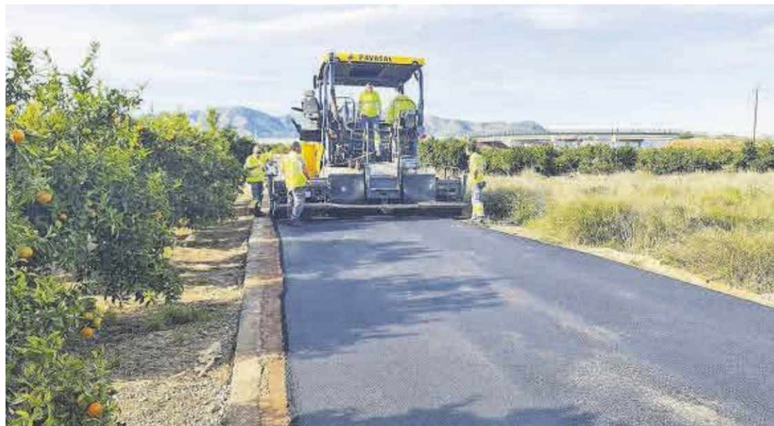
L'Ajuntament de Nules continua treballant en l'asfaltat i millora dels camins rurals del terme municipal.
